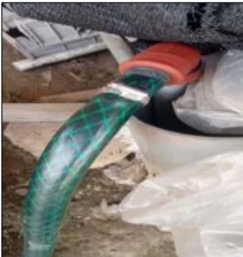
Figura 23. conexión de manguera al suministro de agua
